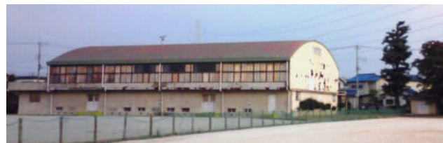
ガラスが割られ、傷みの激しい旧霞ヶ関北小体育館。手前右側は整備されたグラウンド。
