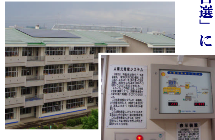
市内小中学校に設置されている太陽光発電システム 太陽光パネル（霞ヶ関北小）と表示盤（上戸小）
